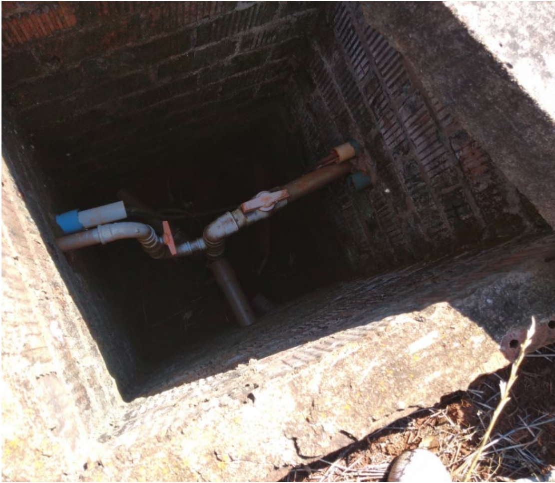
Figura 12. Caixa de distribuição do poço tubular 05.
